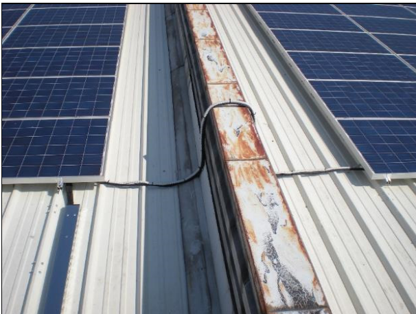
Abbildung 160 PV-Leitungen überbrücken den Brandabschnitt
