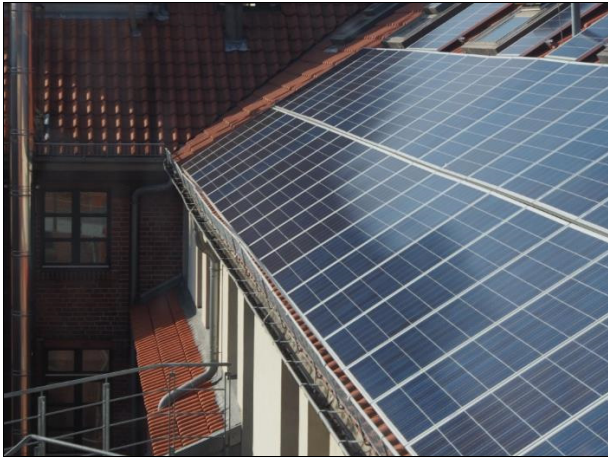
Abbildung 158 PV-Module sind bis an das Schneefanggitter heran geführt
