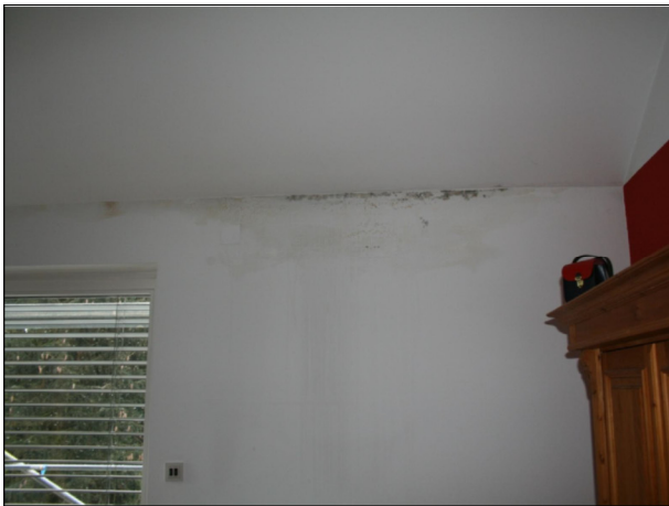
Abbildung 139 Durchfeuchtungen des Dachaufbaus im Traufbereich
