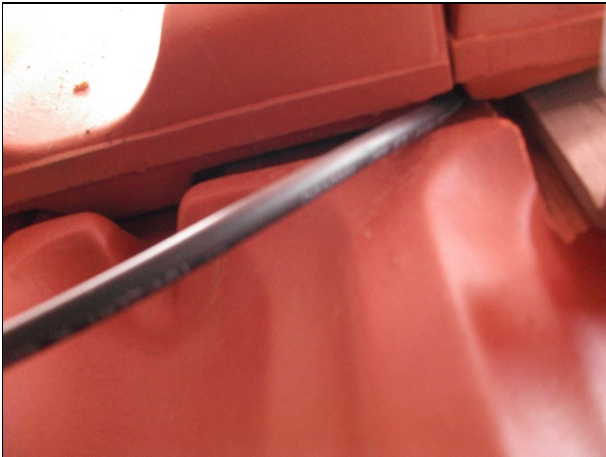
Abbildung 187 ungeschützte Einführung einer Strangleitung
