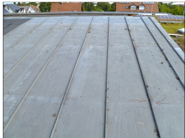
Abbildung 98 Zinkblechdach nach Entfernen der Modulträger, Beschädigungen der Stehfalze (mit Pfeilen gekennzeichnet)
