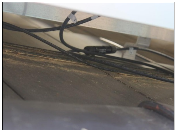
Abbildung 54 Lose auf den Dachziegeln aufliegende Elektrokabel und Steckverbindungen
