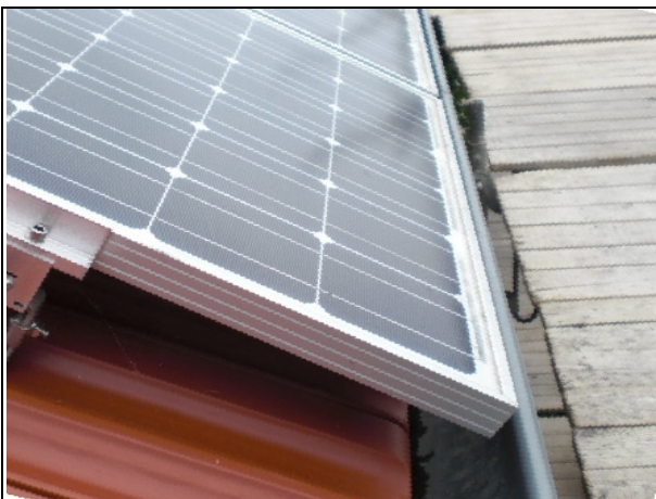
Abbildung 156 PV-Module ragen über die Dachrinne
