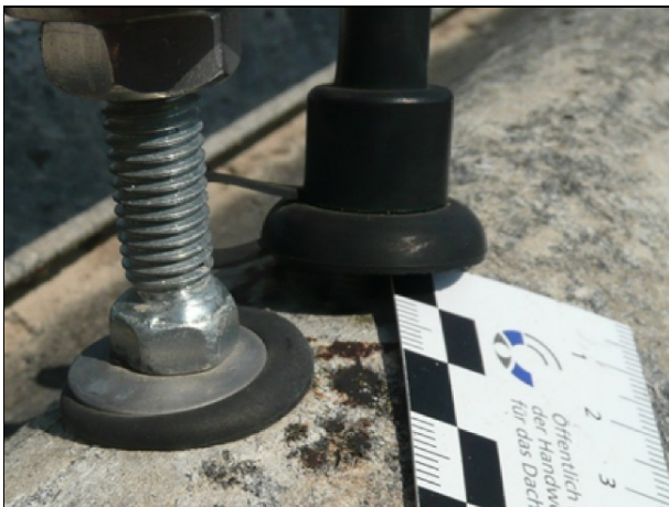
Abbildung 129 Durch die in unmittelbarer Nähe erfolgte neue Befestigung ist die alte Befestigung der Wellplatten entlastet und undicht geworden.
