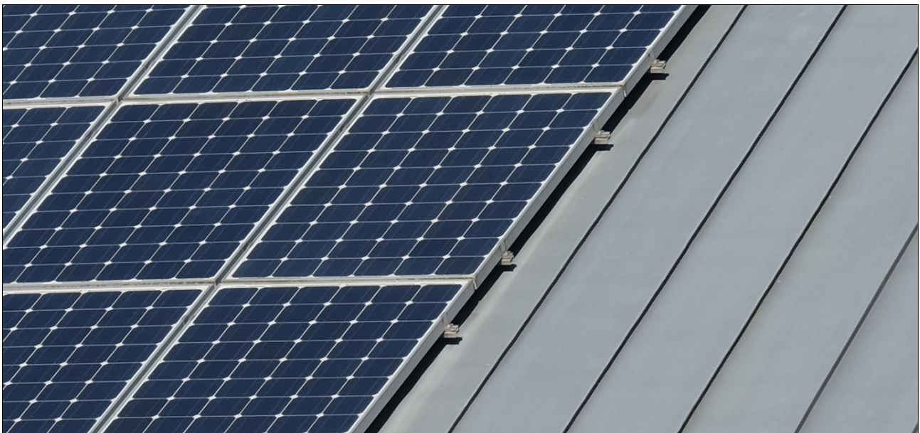
Abbildung 202 Solaranlage auf Zinkblechdeckung
