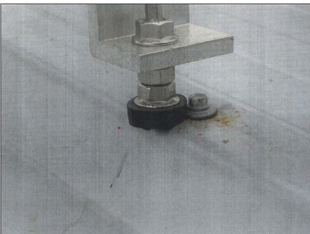
Abbildung 111 Befestigung am Rand der Obergurte, daher keine vollflächige Auflage des Dichtrings
