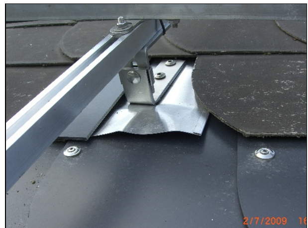
Abbildung 68 Nicht ausreichende Überdeckung der Blechformelemente, sichtbare Verschraubung der neuen Deckplatten, offene Befestigung der Dachhaken ohne Dichtscheiben
