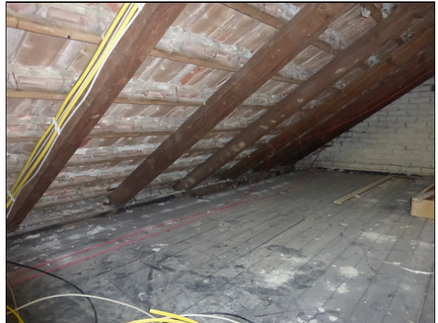
Abbildung 22 Nicht ausgebauter Dachraum, keine Unterspannbahn, sondern Mörtelverstrich als Zusatzmaßnahme für die Regensicherheit
