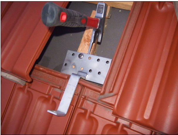
Abbildung 35 Lediglich mit einer Schraube befestigter Haken, Abstand zwischen Haken und aufgelatteten Sparren
