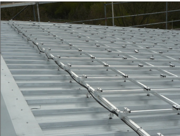
Abbildung 107 Befestigung der Solarmodule auf jedem zweiten Obergurt mit Stockschrauben und Dichtringen für Welleternitplatten
