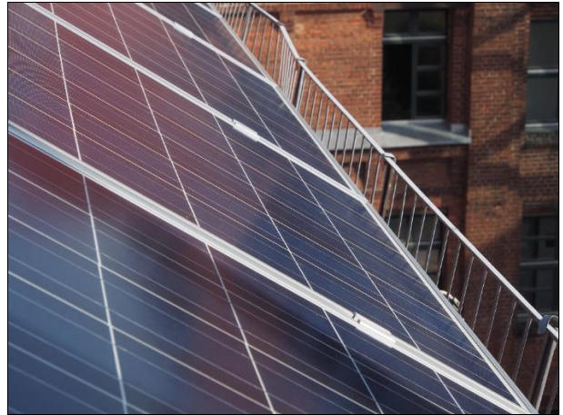
Abbildung 159 Die Funktion der Schneefanggitter wird deutlich eingeschränkt.
