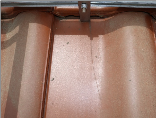
Abbildung 29 Ziegelbruch längs, vom Haken ausgehend
