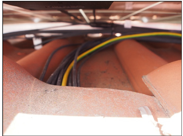
Abbildung 192 ungeschützte Durchführung von PV-Leitungen unter Dachziegel
