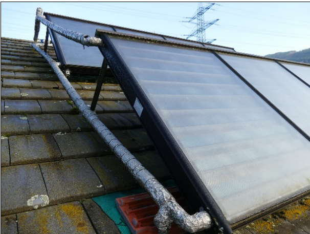
Abbildung 45 Aufgeständerte solarthermische Anlage
