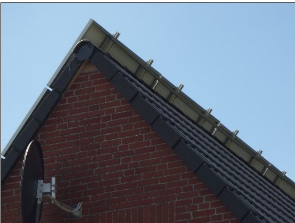
Abbildung 177 Die obere waagerechte Modulschiene ist nicht am Dach befestigt.
