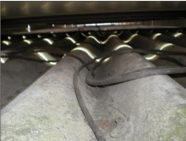
Abbildung 183 Unbefestigte Modul- und Strangleitungsverlegung auf einer Wellfaserzementdeckung
