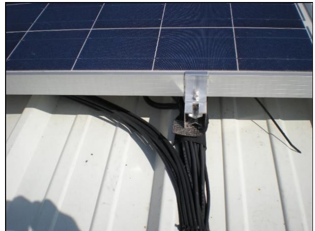
Abbildung 196 Nicht fachgerechte und nicht ausreichend befestigte Verlegung der Leitungen auf einem Trapezblechdach.
