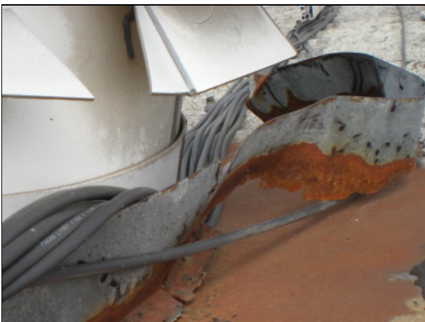
Abbildung 193 ungeschützte Verlegung über scharfkantiges Blech
