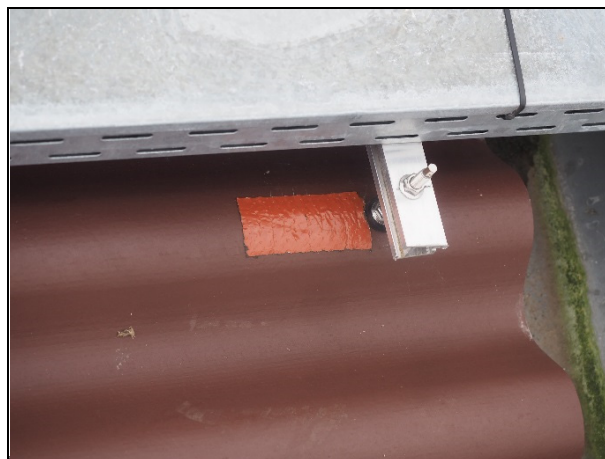
Abbildung 134 Reparaturstelle ohne zusätzliche Lackierung
