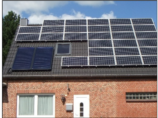
Abbildung 176 Der PV-Generator wurde über den Dachfirst geführt
