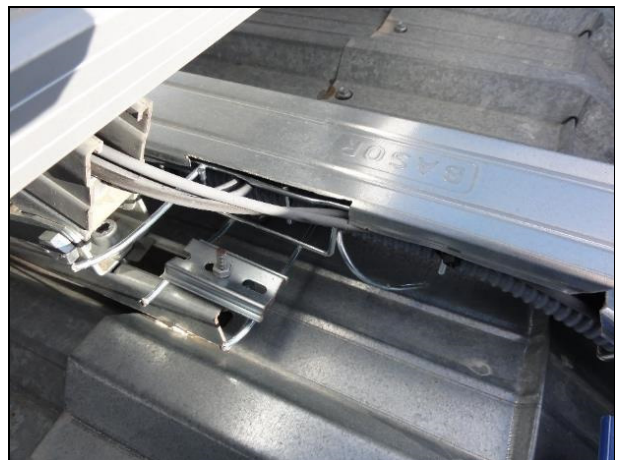
Abbildung 194 ungeschützte Verlegung an scharfkantiger Blechkanalabdeckung
