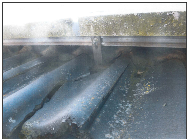
Abbildung 44 Längs gebrochener Dachstein unter einem Dachhaken
