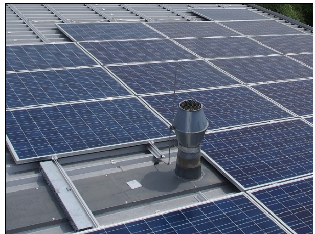
Abbildung 170 Mindestabstände zum Schornstein bei einem Gewerbegebäude unterschritten
