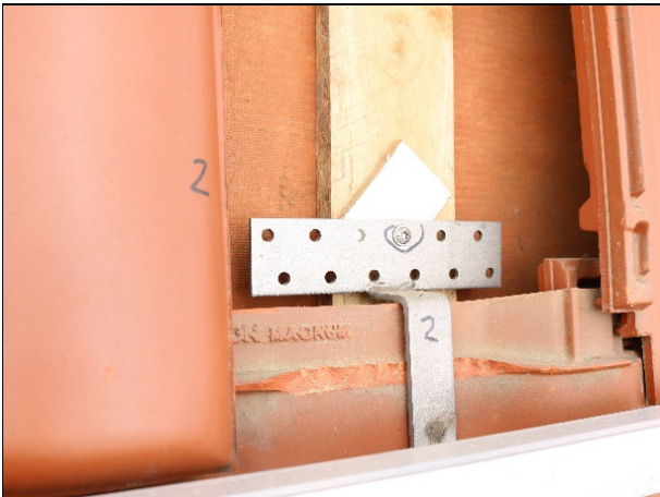
Abbildung 33 Ungeeignete und mit zu geringer Auflage montierte Unterlage, Haken mit nur einer Schraube befestigt
