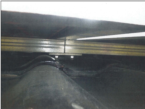
Abbildung 49 Verbindungselemente der Modulunterkonstruktion stoßen an die Dachziegel
