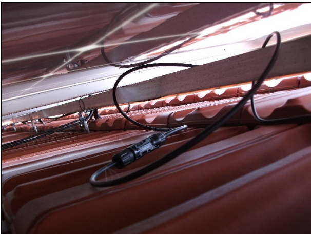
Abbildung 179 Unbefestigte Modulleitungsverlegung auf einem Ziegeldach, Steckverbinder liegen auf den Dachziegel auf
