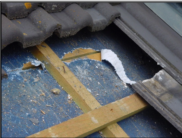
Abbildung 229 Zerstörung der Unterdeckbahn über einem Dämmplattenstoß (aus [AIBau 2013])
