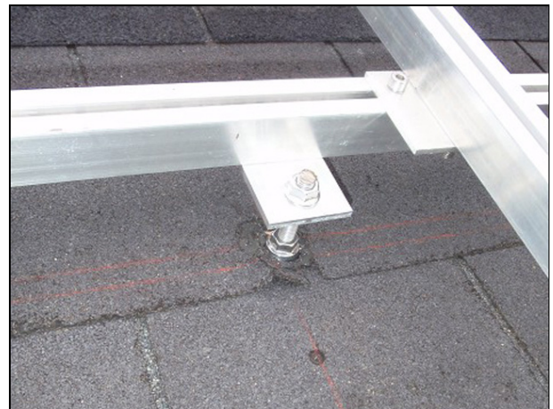
Abbildung 78 Unzureichende Abdichtung der Durchdringungen nur mit kleinflächigen Dichtringen
