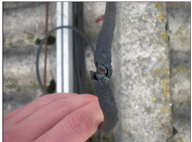
Abbildung 190 unsachgemäße Leitungsverlegung über scharfe Kanten führte zur Isolationschädigung
