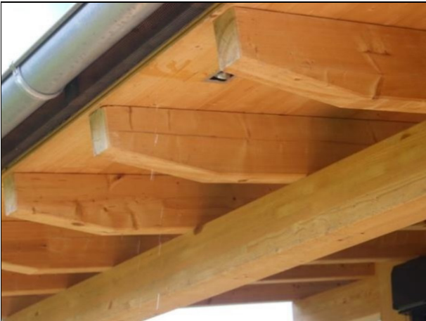
Abbildung 51 Abtropfungen durch Einbaustrahler und aus den Belüftungsschlitzen nach Probewässerung
