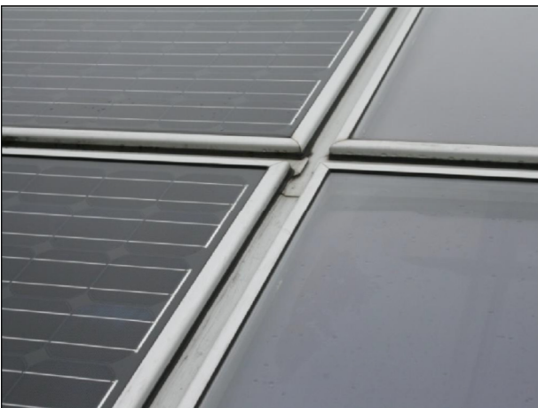
Abbildung 149 Verbindungsbleche zwischen den Modulen wurden überlappend ausgeführt.
