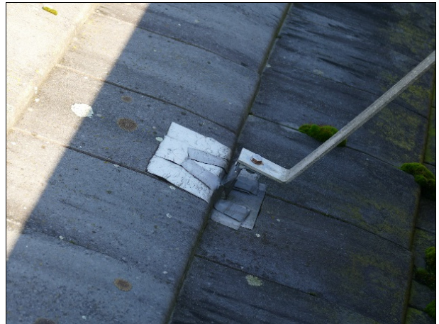
Abbildung 46 Mit Klebebändern bearbeitete Durchdringungsstellen der Dachhaken
