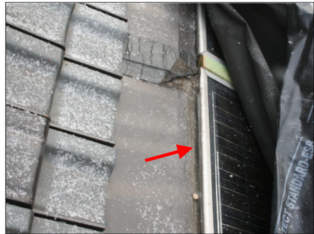
Abbildung 140 Nicht funktionstüchtige Verbindung zwischen Indach-Modulen und Anschlussblechen
