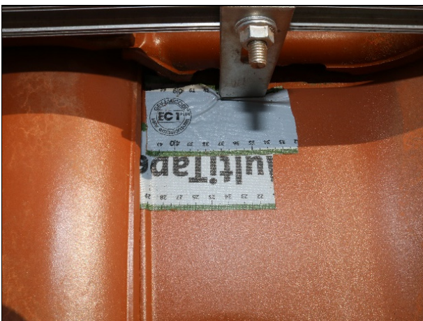
Abbildung 31 Provisorisch abgedeckter Bruch
