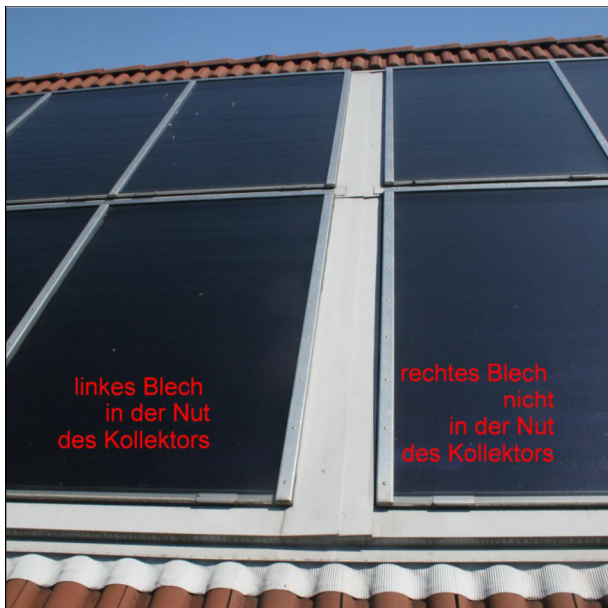
Abbildung 143 Indachanlage mit vertikalen Anschlussblechen zwischen den Modulfeldern
