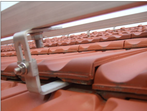
Abbildung 63 Bearbeitung an falscher Stelle, dadurch angehobener Ziegel
