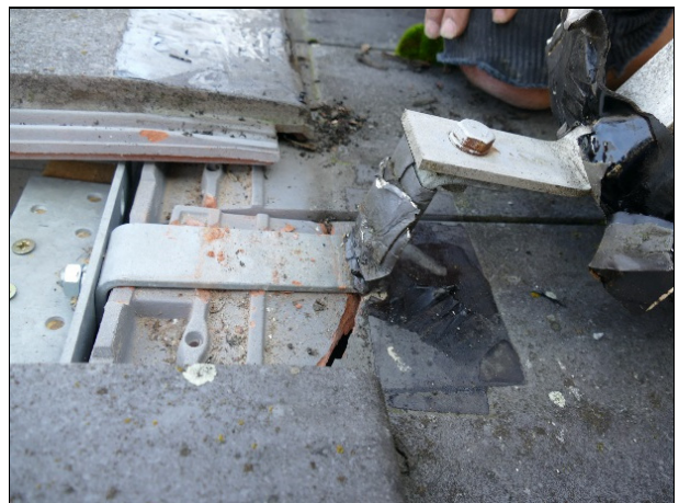
Abbildung 48 Dachhaken liegt auf Ziegelsteinen auf.
