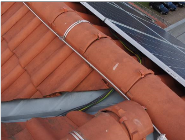
Abbildung 189 ungeschützte Durchführung von Strangleitungen unter dem Firststein
