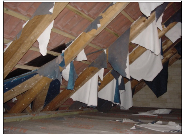
Abbildung 232 Aufgelöste Unterspannbahn (aus [AlBau 2013])
