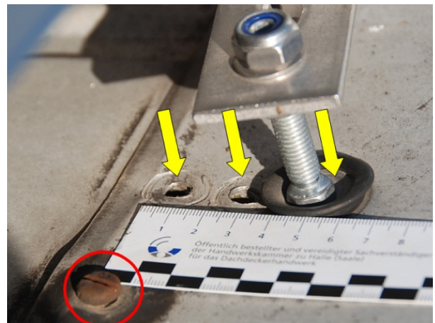
Abbildung 120 Nicht geschlossene Fehlbohrungen
