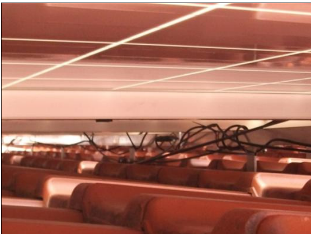
Abbildung 181 Modul- und Strangleitungen sowie Steckverbinder liegen auf dem Ziegeldach auf
