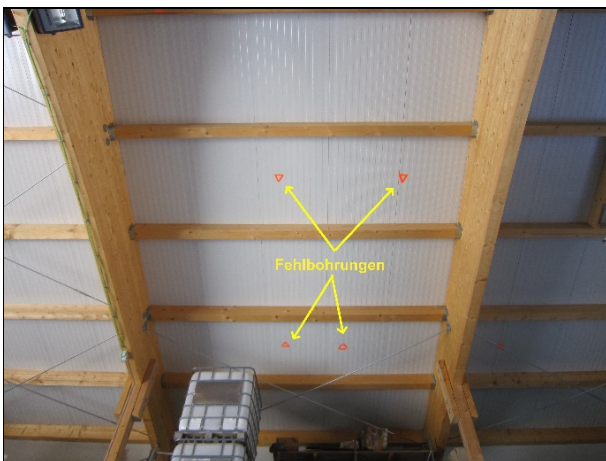
Abbildung 103 Fehlbohrungen in der Sandwichdachschaale
