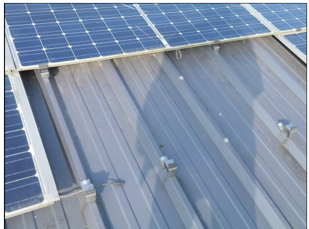
Abbildung 122 Die Module wurden systembedingt in die oberen und unteren Halten jeweils nur eingeschoben.
