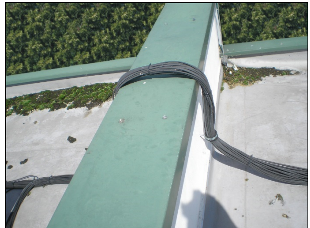
Abbildung 161 Ungeschottete PV-Leitungen wurden über die Brandwand geführt
