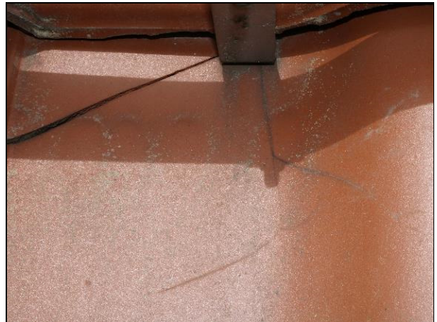
Abbildung 34 Ziegelbruch an ca. 10 % der verbauten Haken
