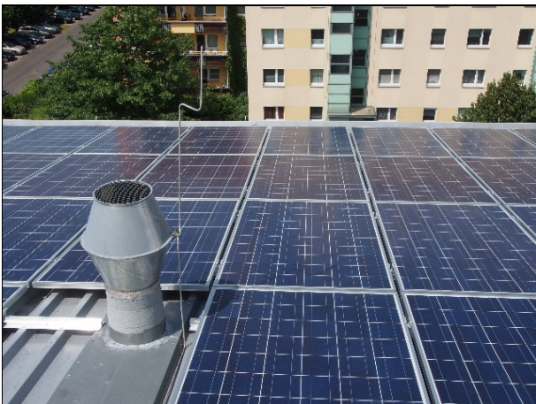
Abbildung 169 Mindestabstände zum Schornstein bei einem Gewerbegebäude unterschritten
