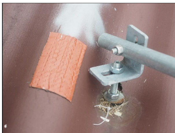
Abbildung 136 Beschädigungen durch Befestigungselement (Stockschraube) eines Entlüfters
