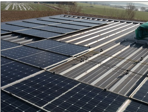
Abbildung 121 Sandwichdeckung mit schindelförmig verlegten PV-Modulen. Ein Teil der Module wurde nach einem Sturmereignis aus den Halterungen gerissen.
