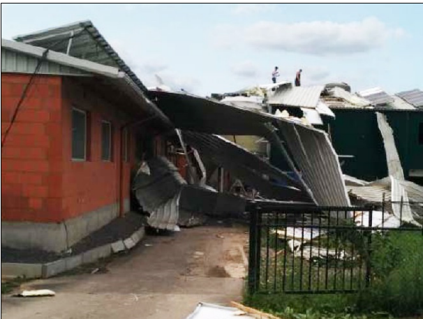
Abbildung 137 abgetragene Deckung und benachbartes Gebäude mit Solaranlage
