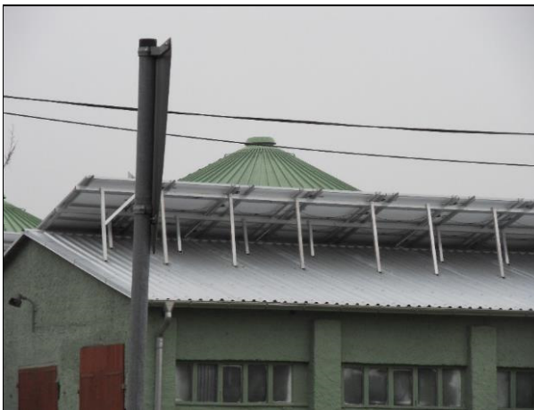
Abbildung 171 PV-Module sind über den Dachfirst gebaut
