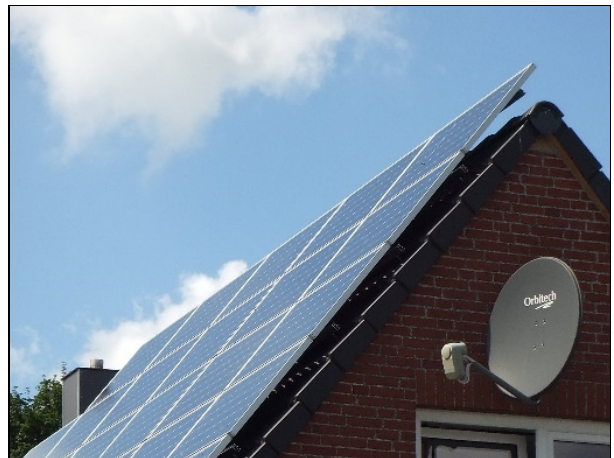
Abbildung 178 Überstand der PV-Module über den Dachfirst
