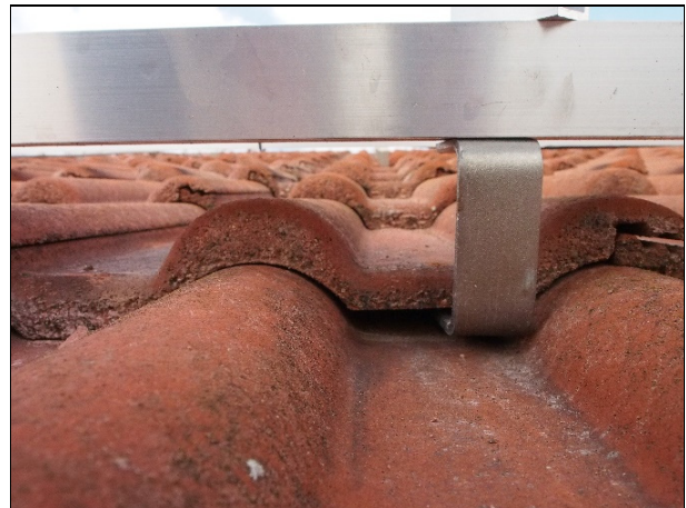
Abbildung 62 Bearbeiteter Ziegel im Bereich des Hakens
