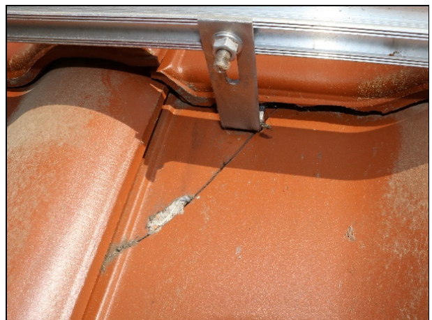
Abbildung 32 Ziegelbruch quer, vom Haken ausgehend
