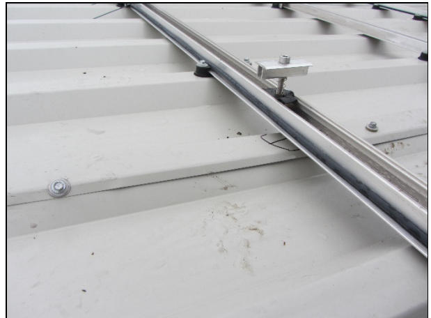
Abbildung 96 Links: Schraube im Knickbereich des Blechs, rechts: markierte Stelle
