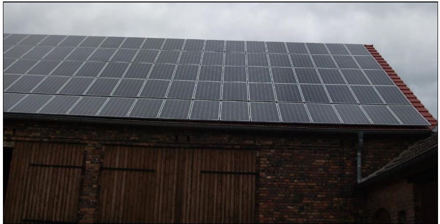
Abbildung 155 Die Dachfläche wurde maximal belegt. Die Abstände zum First, zur Traufe und zum Dachrand sind äußerst gering.
