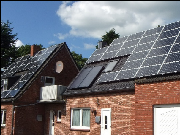
Abbildung 175 PV-Generator und Solarthermieanlage an einem Einfamilienhaus.
