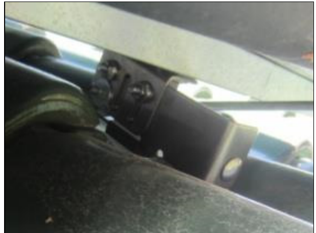
Abbildung 39 Das elastische Auflager liegt nicht auf, der Dachhaken ist nach unten gekippt und belastet mit seiner Vorderkante den darunter liegenden Ziegel unterhalb der Traglatte.
