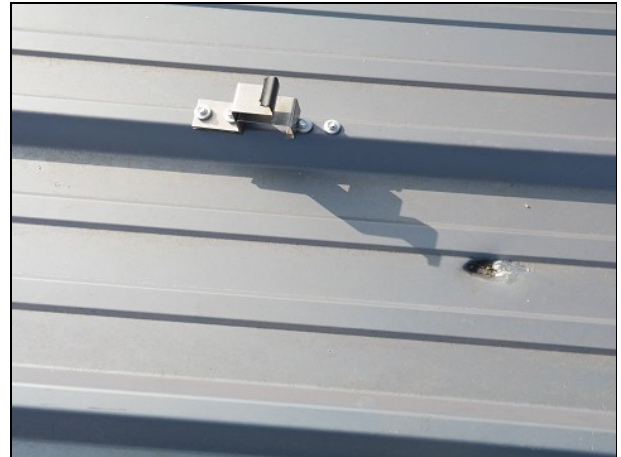
Abbildung 124 Befestiger des Modulsystems und mechanische Be- schädigung der Sandwichdeckung
