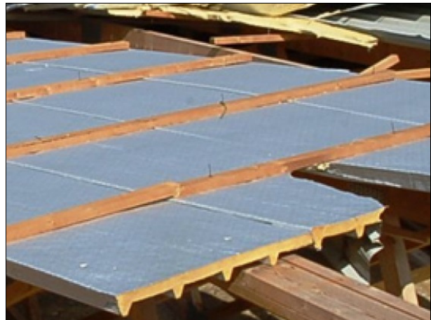
Abbildung 138 Sandwichdeckung mit der abgelösten Holzlattenun- terkonstruktion
