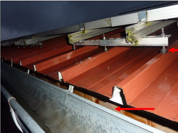
Abbildung 99 Befestiger der Solaranlage (Pfeil oben) und Ablaufspuren an der Pfette darunter (Pfeil unten)
