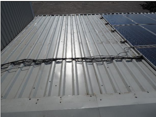
Abbildung 195 ungeschützte und unbefestigte Verlegung auf einem Trapezblechdach
