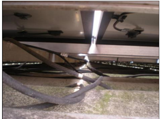
Abbildung 184 Unbefestigte Modul- und Strangleitungsverlegung auf einer Wellfaserzementdeckung
