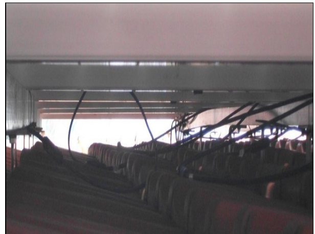
Abbildung 182 Modul- und Strangleitungen sowie Steckverbinder liegen auf dem Ziegeldach auf
