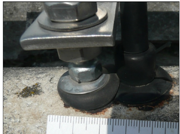
Abbildung 130 Aufeinander sitzende Dichtungen / eng beieinander montierte Schrauben führen zu Schadstellen mit Bruchgefahr
