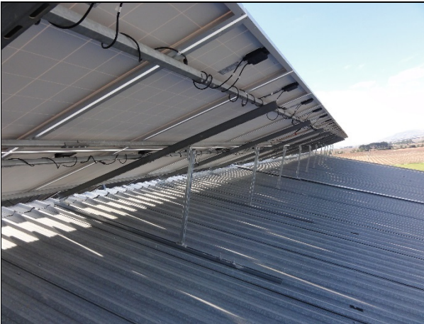
Abbildung 173 PV-Module sind auf dem Trapezblechdach über den Dachfirst gebaut
