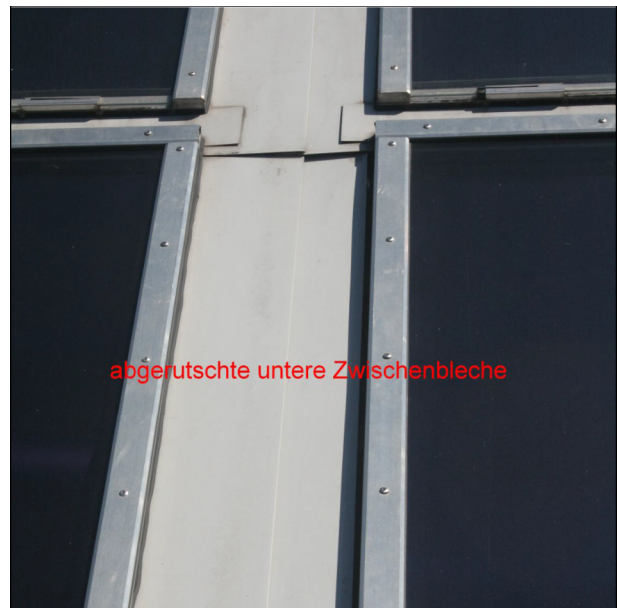
Abbildung 144 Die vertikalen Anschlussbleche sind über Liegefalze, die nicht fachgerecht ausgeführt waren, miteinander verbunden
