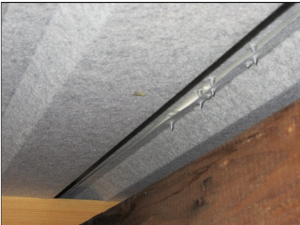
Abbildung 91 Aufgebogene Bleche bei Überlappung durch Schrauben der UK
