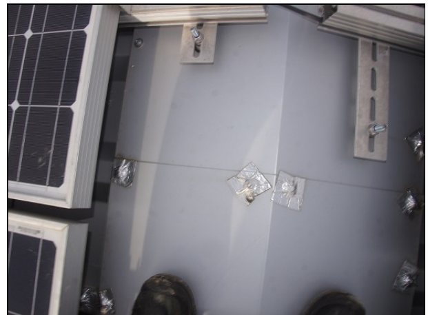
Abbildung 80 Schraubbefestigungen am First wurden mit Klebebändern eingedichtet.
