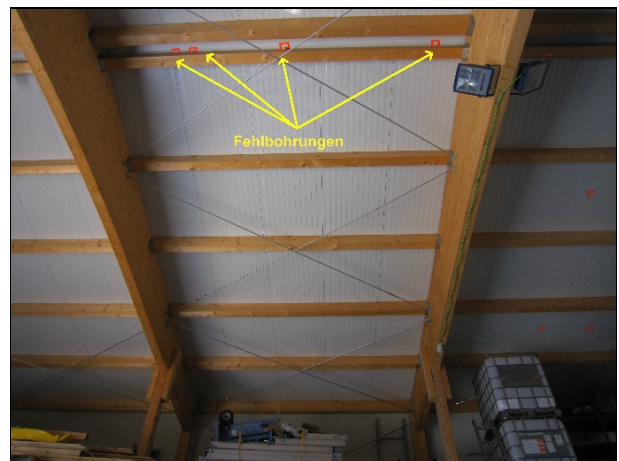
Abbildung 104 Fehlbohrungen in der Sandwichdachschaale
