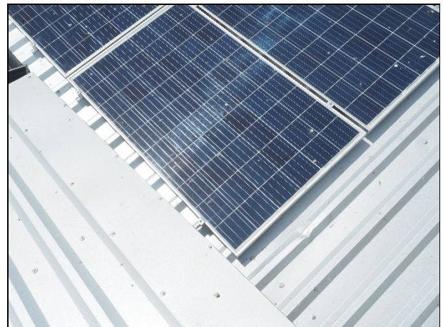
Abbildung 84 Blick vom erhöhten Dach aus auf die darunter liegende Dachfläche mit Verformungen an der Blechoberseite
