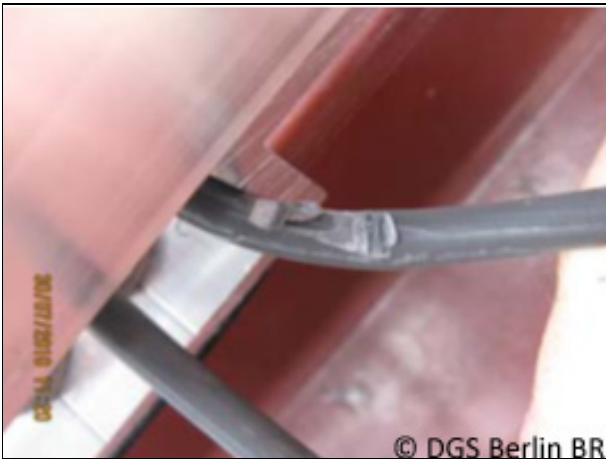
Abbildung 191 unsachgemäße Leitungsverlegung über scharfe Kanten führte zur Isolationschädigung
