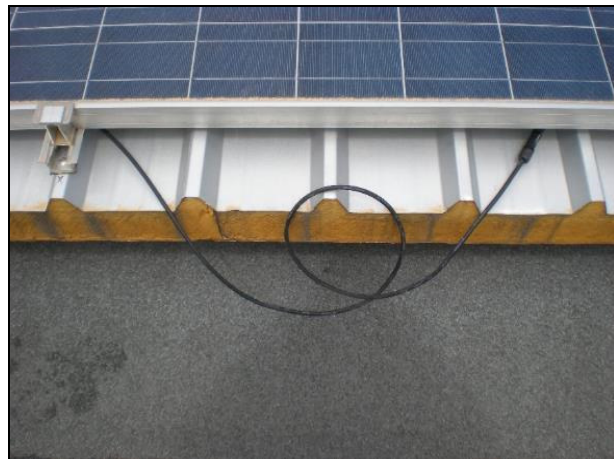
Abbildung 186 unbefestigte Strangleitung auf einem Sandwichdach
