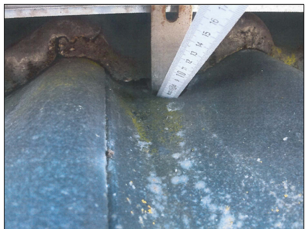
Abbildung 42 Durch das ausgestanzte Loch im Betondachstein konnte ein Zollstock durchgesteckt werden
