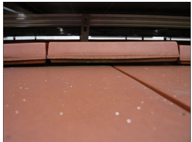
Abbildung 56 Durch Druck auf den oberen Ziegelfalz wird die untere Kante des Ziegelsteins angehoben.
