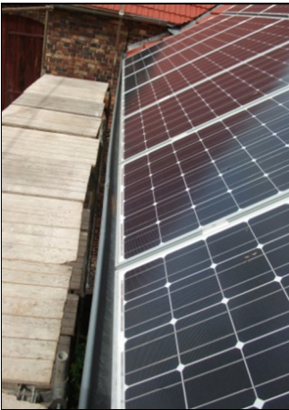
Abbildung 154 PV-Module ragen über die Dachrinne
