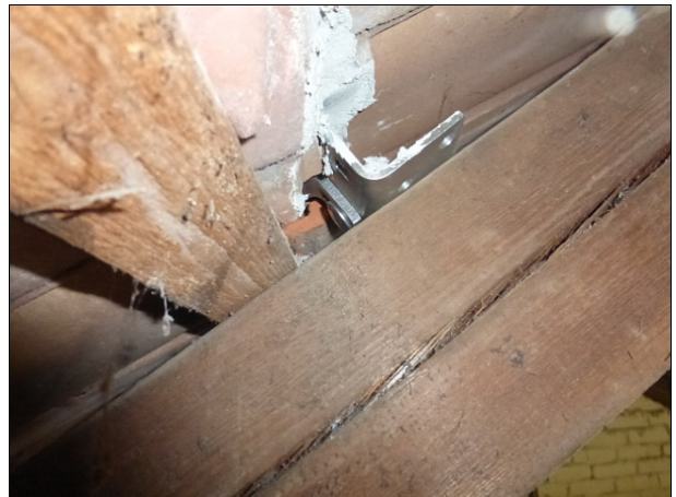
Abbildung 24 Nicht vollständig wiederhergestellter oder wieder abgebrochener Mörtelverstrich bei Dachhaken-durchdringung
