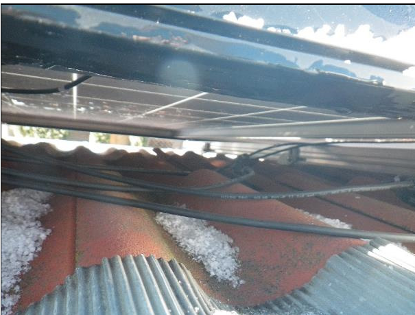
Abbildung 185 Schnee und Eis kann Zugspannungen auf die unbefestigten Modul- und Strangleitungen ausüben.
