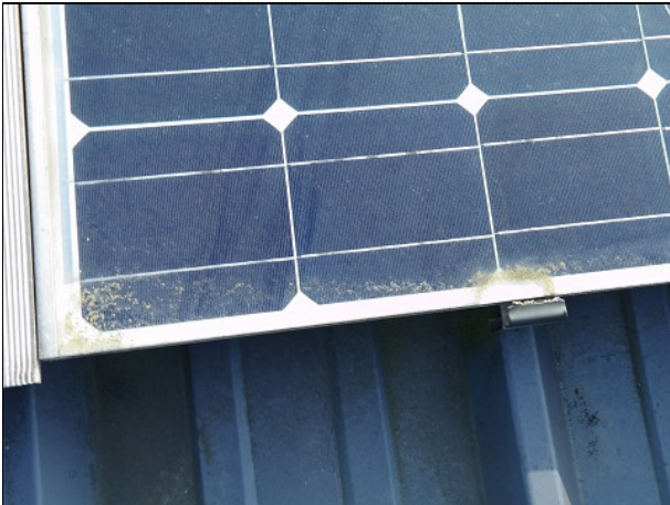
Abbildung 123 Nach oben verschobenes und damit unterseitig nicht mehr gehaltenes Modul
