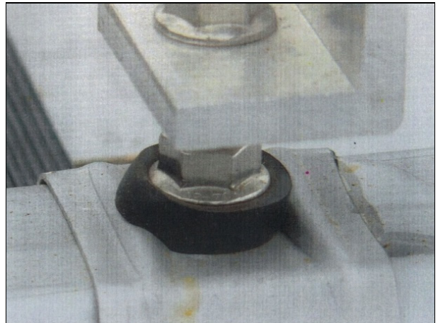
Abbildung 110 Montage über Kalotte, aber mit Verformung des Dichtrings
