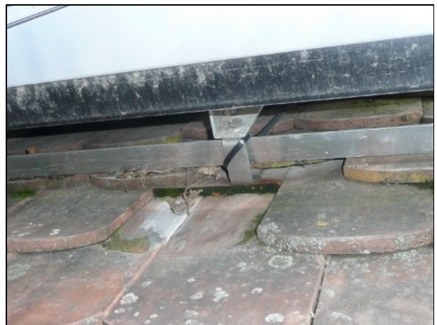
Abbildung 60 Abgebrochener Biberschwanzziegel unter dem Dachhaken. Der untere Teil des Ziegels ist abge- rutscht.
