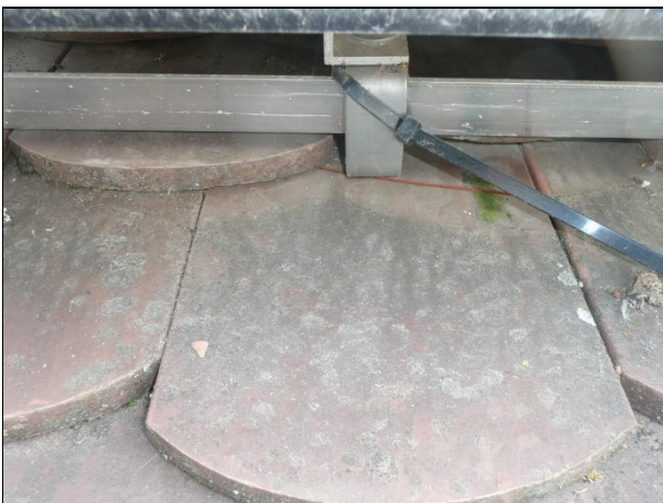
Abbildung 59 Nach unten verschobener Biberschwanzziegel mit Bruchlinie unter dem Dachhaken
