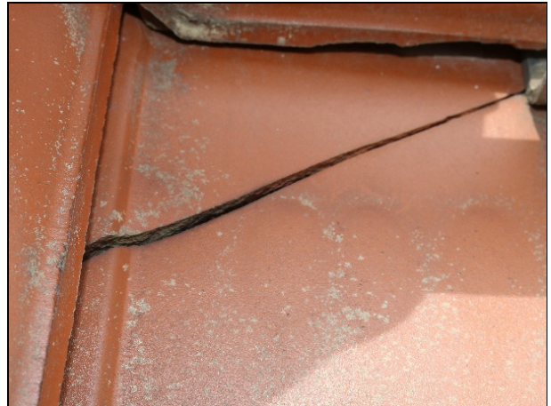
Abbildung 30 Ziegelbruch quer, vom Haken ausgehend
